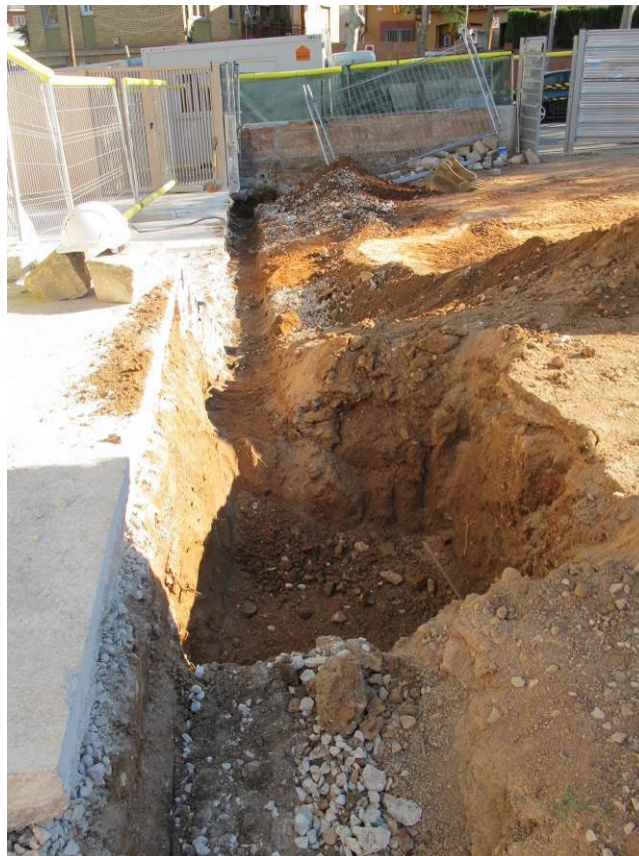
Foto 62: Tram final amb pou-arqueta
